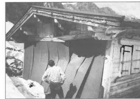
Lawinenschaden an der Hütte
