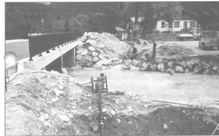
Rohrbruch in Salzbach-Benesboden
