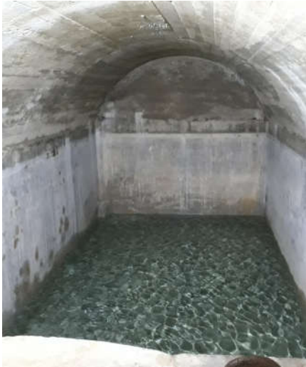
Aktueller Hochbehälter „Kirchplatzl“, seit 1929 in Betrieb. Foto: Jochen Neuner
